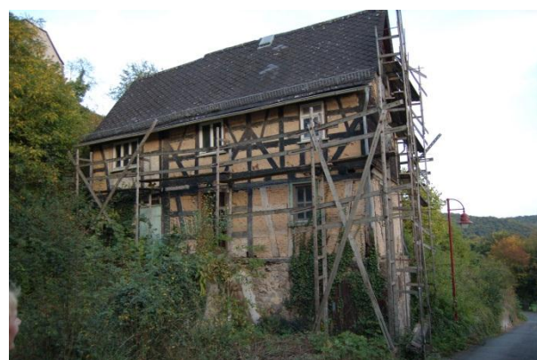
Blick auf ein stark sanierungsbedürftiges und denkmalgeschütztes Gebäude in der Wiesenstraße.
