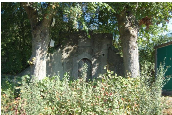
Am Alten Wasserhochbehälter im Bereich der Vorfläche sind Sanierungsarbeiten notwendig.
