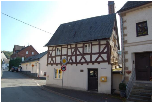
Die Bausubstanz des Backhauses ist sanierungsbedürftig.
