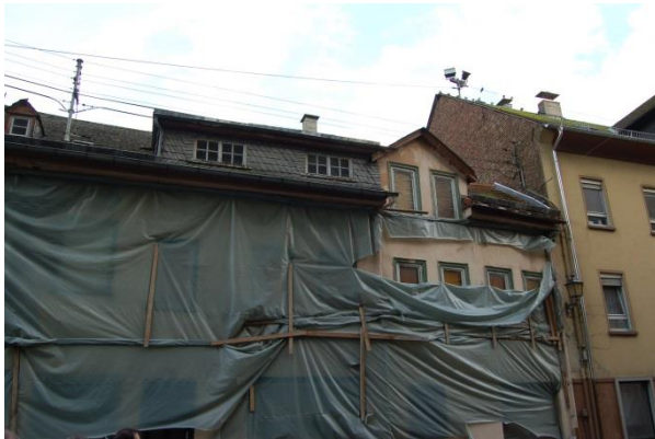
Das baufällige Gebäude beeinträchtigt das Ortsbild in der Burgstraße.
